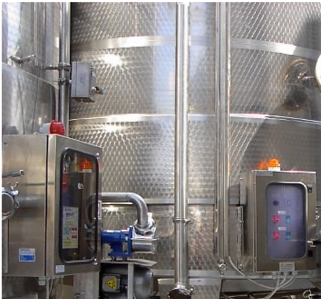
Figura 47 elementi adeguatamente protetti
