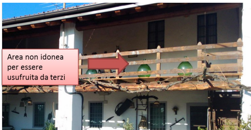
Figura 36 area non idonea per essere fruibile da terzi (parapetto in legno non conforme per resistenza e struttura)
