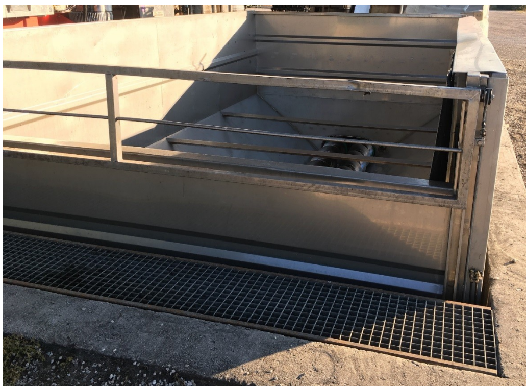
Figura 28 Chiusura della vasca di conferimento all'impianto durante la fase di non utilizzo della macchina
